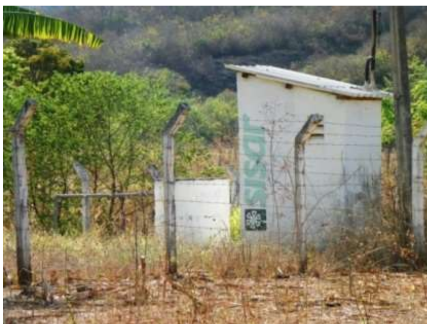
Figura 5.4 – Poço tubular ( Q = 4,1 \text{ m}^3/\text{h} ) que atende a localidade de Cachimbo, distrito de São Romão, no município de Altaneira. Fonte: Consórcio DGH-Cariri (2011).
