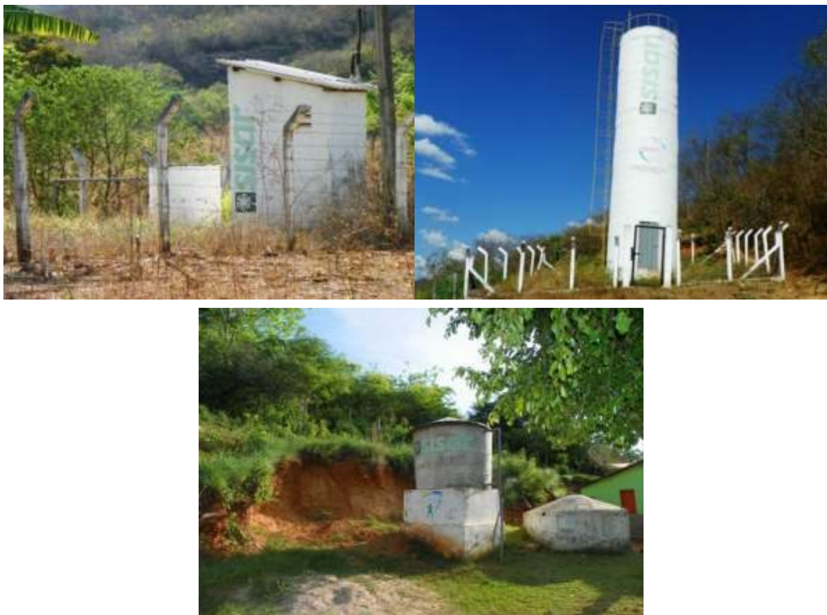
Figura 5.8 – Poço tubular ( Q = 4,1 \text{ m}^3/\text{h} ) e reservatórios elevados de 30 \text{ m}^3 (atende 195 imóveis) e 5 \text{ m}^3 (atende 16 imóveis) da localidade de Cachimbo, distrito de São Romão, no município de Altaneira.
