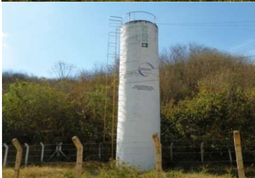
Figura 5.9 – Poço tubular ( Q = 5,3 \text{ m}^3/\text{h} ) e reservatório elevado de 30 \text{ m}^3 que atende a localidade de Bananeira, distrito de São Romão, no município de Altaneira.
