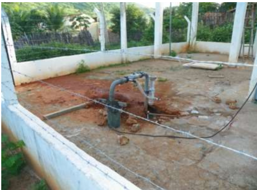
Figura 5.3 – Vista do poço tubular ( Q = 7,2 \text{ m}^3/\text{h} ), responsável pela distribuição de água da zona urbana do distrito de São Romão. Fonte: Consórcio DGH-Cariri (2011).
