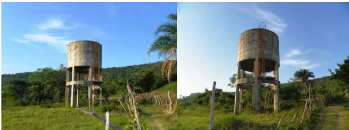
Figura 5.6 – Vista do reservatório elevado REL (50m 3 ) do distrito de Jardimirim. Fonte: Consórcio DGH-Cariri (2011).
