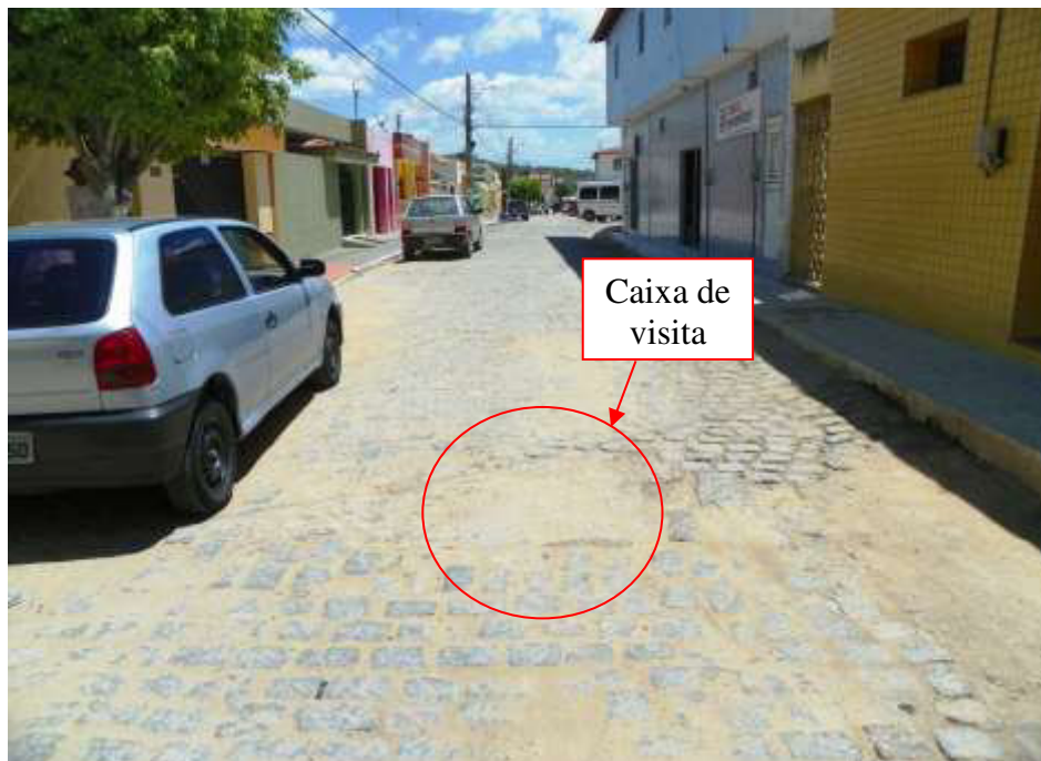
Figura 5.2 – Caixa de visita – Rua Cel. Rocha na sede de Jardim. Fonte: Consórcio DGH-Cariri (2011).
