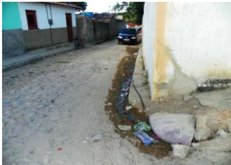
Figura 5.14 – Esgoto lançado a céu aberto na Rua Professora Albuina no distrito de Horizonte.
