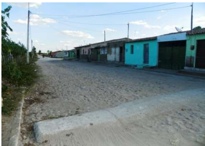
Figura 5.24 – Rua Nossa Senhora das Dores – ponto de alagamento no distrito de Horizonte. Fonte: Consórcio DGH-Cariri (2012).
