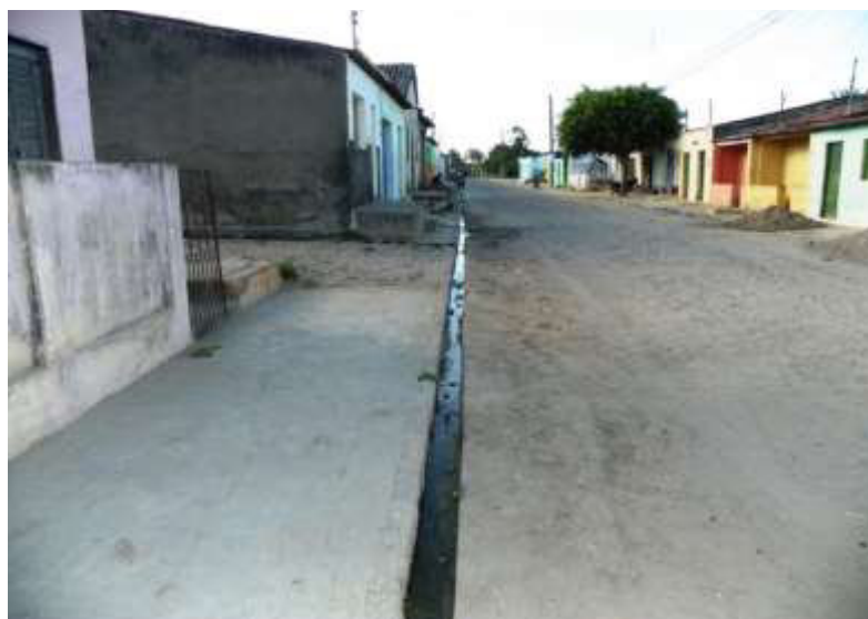
Figura 5.15 – Esgoto lançado a céu aberto na Rua Nossa Senhora das Dores no distrito de Horizonte.
