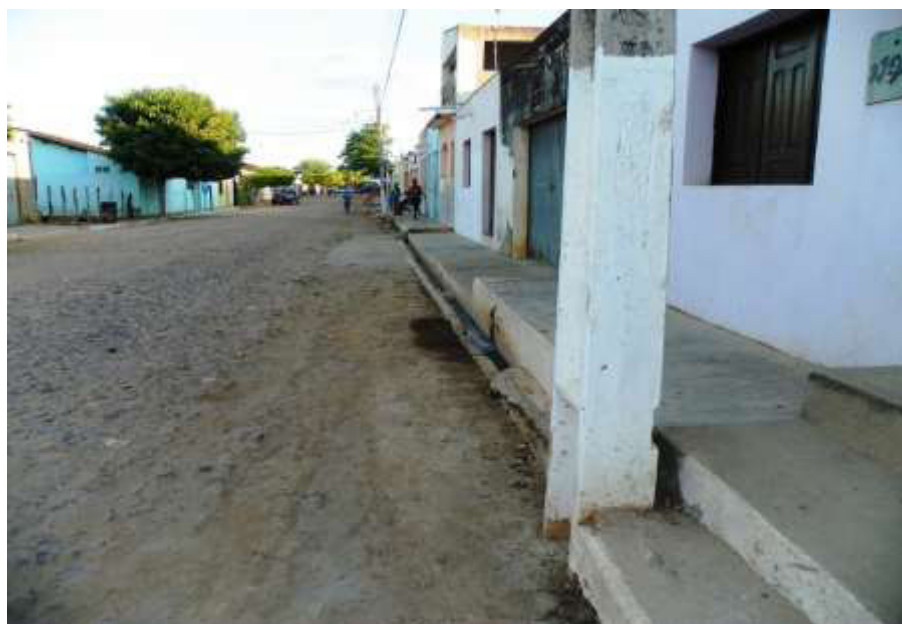
Figura 5.13 – Esgoto lançado a céu aberto na Rua João Aquino Pinheiro no distrito de Corrente.
