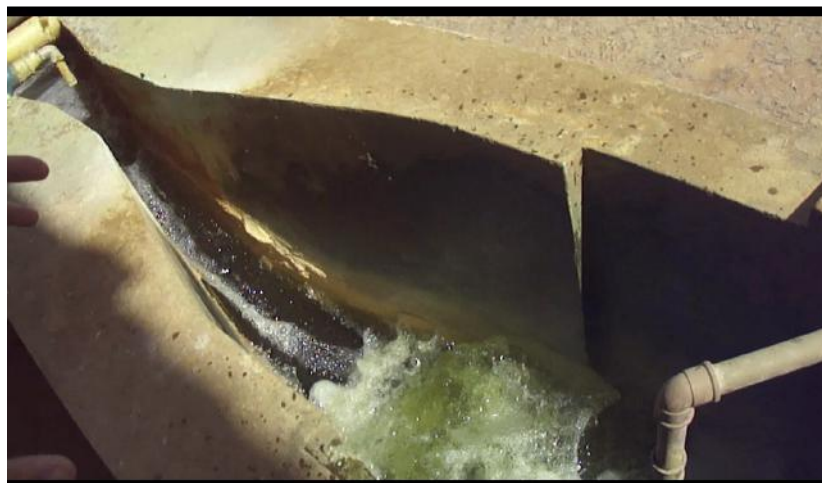
Figura 21 - Medidor de vazão do tipo Calha Parshall e a subsequente mistura rápida com inserção do Sulfato de Alumínio por uma encanação própria, no canto inferior direito da foto – ETA I Quixeramobim.
