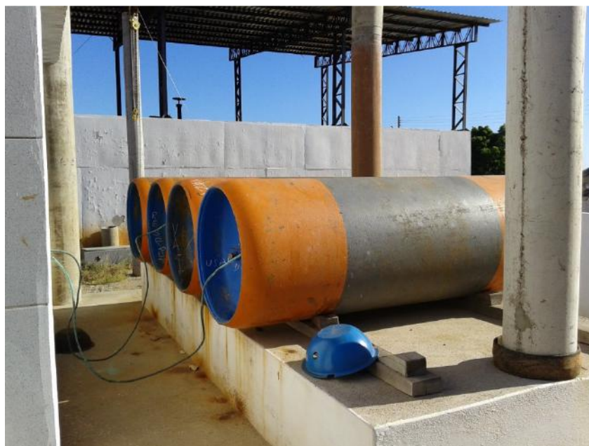
Figura 25 - Sistema de cloração com cilindro de cloro gás - 900kg.
