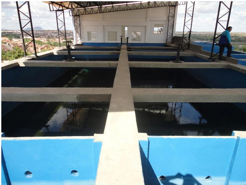
Figura 23 - Tanques de decantação da ETA I de Quixeramobim.
