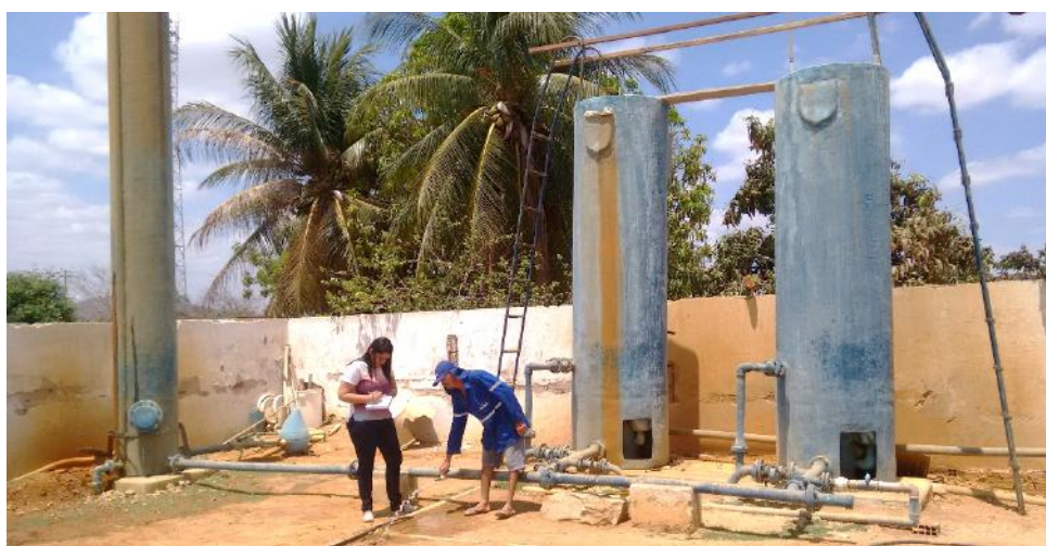
Figura 37 - Unidades da Estação de tratamento de água do Distrito de Passagem.
