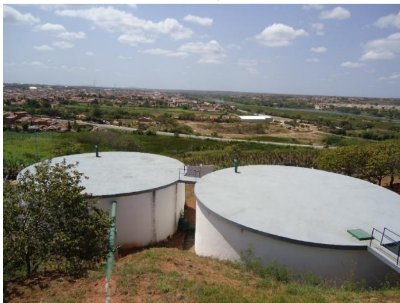
Figura 26 - Reservatórios de distribuição da água após o tratamento nas unidades da ETA.
