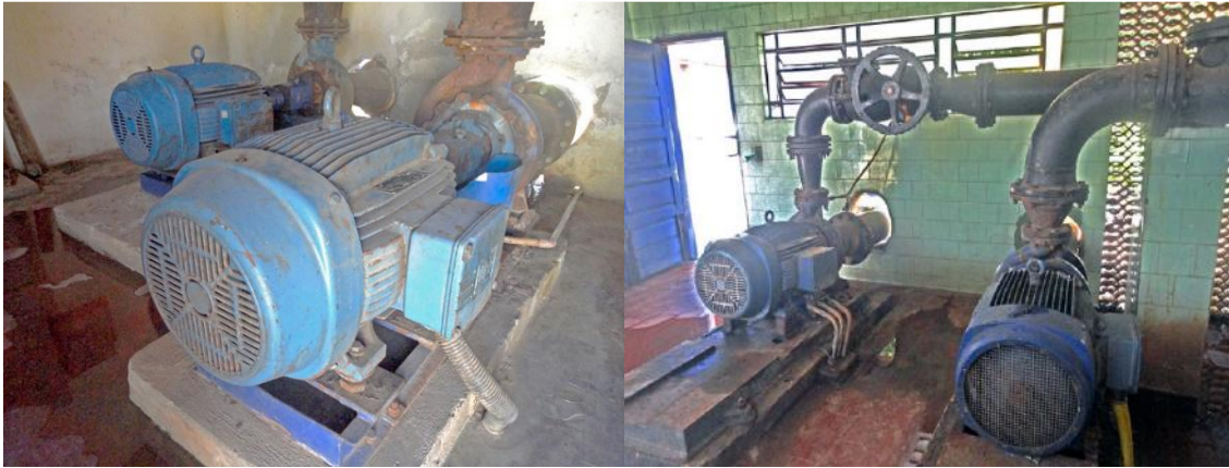
Figura 17 - Sistema de bombas de captação de água bruta.
