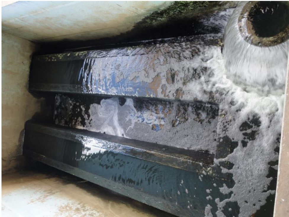
Figura 24 - Filtros de areia da de ETA Quixeramobim.
