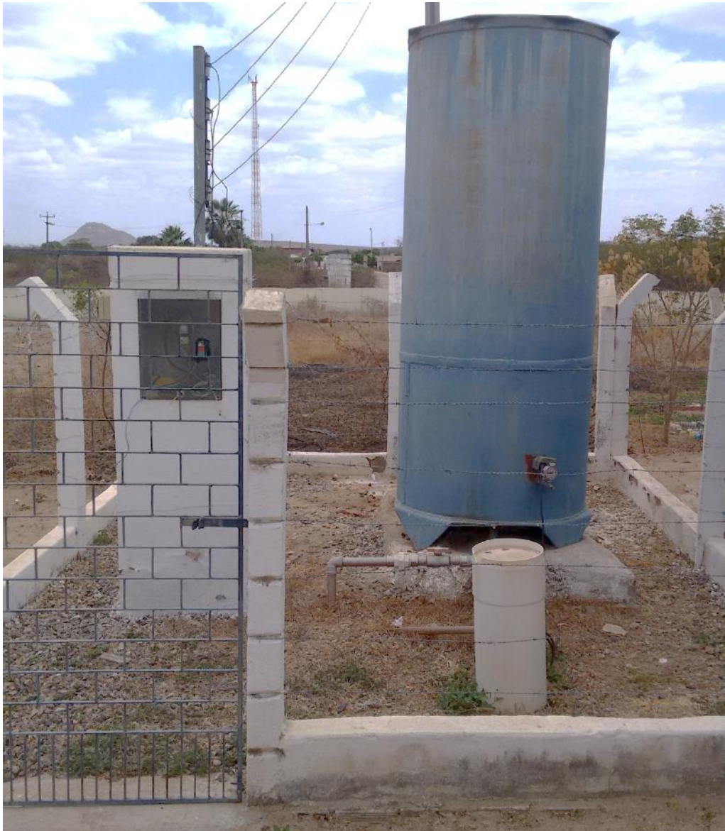
Figura 39 - Caixa pressurizada localizada no Distrito Sede de Manituba.
