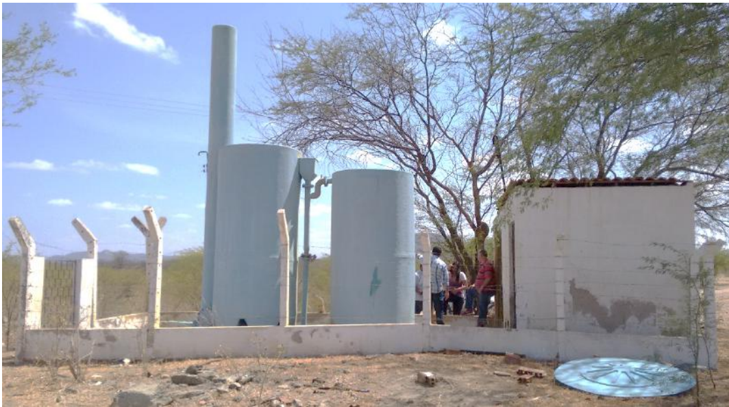
Figura 33 - Estação de Tratamento de água do distrito de Damião Carneiro.
