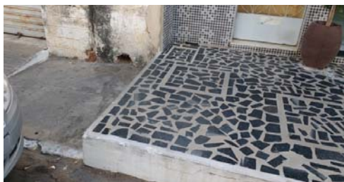
Foto 6 – Calçada com desnível na Rua Cel. Antônio Joaquim
