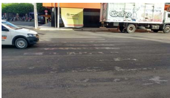
Foto 2 – Faixa de Pedestre apagada e toldo obstruindo o acesso à calçada
