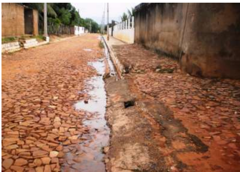
Figura 5.10 – Esgoto a céu aberto no distrito de Estrela. Fonte: Consórcio DGH-Cariri (2011).
