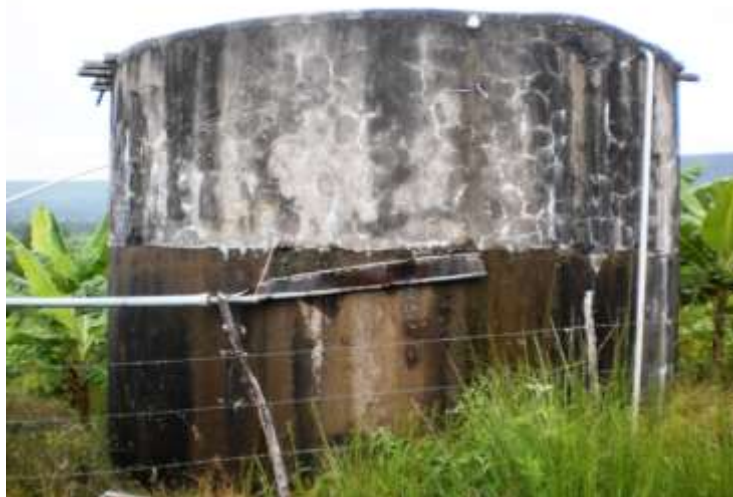
Figura 5.2 – Reservatório apoiado RAP-01 de 15 m 3 que atende ao distrito de Arajara, no município de Barbalha.
