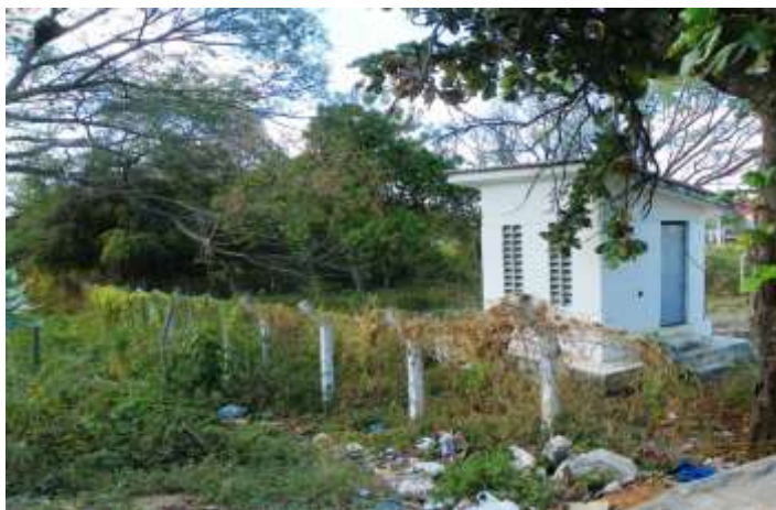
Figura 5.1 – Vista do poço tubular que faz parte do manancial da sede de Barbalha. Fonte: Consórcio DGH-Cariri (2011).
