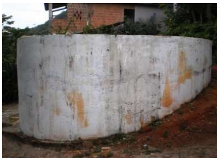
Figura 5.4 – Reservatório apoiado RAP-01 de 10 m 3 que atende ao distrito de Caldas, no município de Barbalha. Fonte: Consórcio DGH-Cariri (2011).
