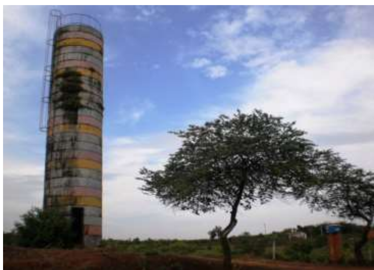
Figura 5.6 – Reservatório elevado REL-02 de 30 m 3 que atende ao distrito de Estrela, no município de Barbalha. Fonte: Consórcio DGH-Cariri (2011).
