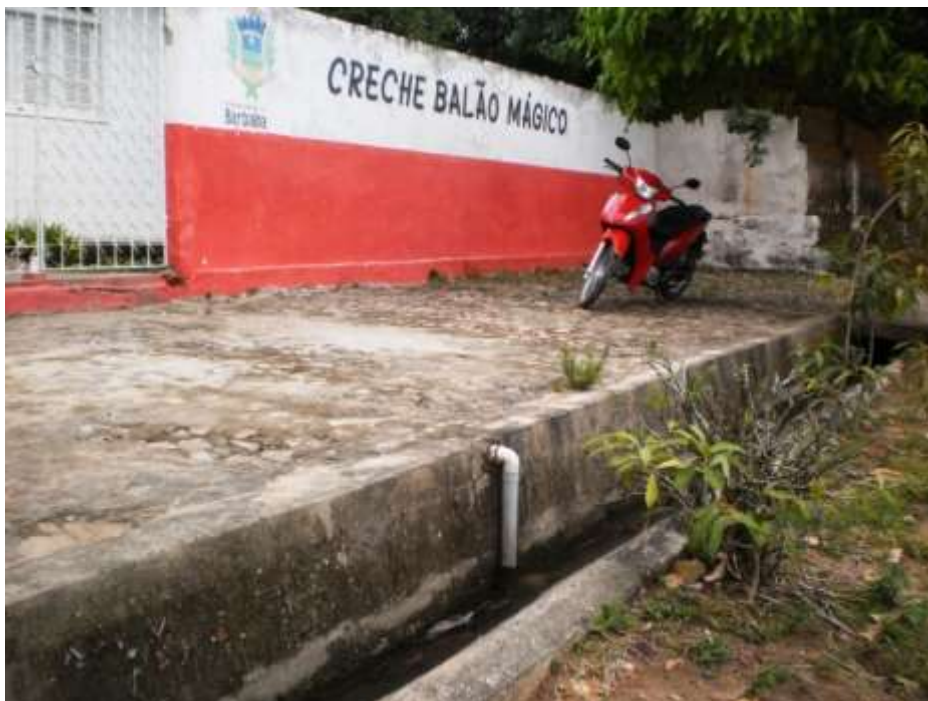
Figura 5.8 – Esgoto a céu aberto no distrito de Arajara. Fonte: Consórcio DGH-Cariri (2011).
