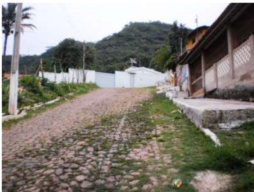
Figura 5.9 – Esgoto a céu aberto no distrito de Caldas. Fonte: Consórcio DGH-Cariri (2011).
