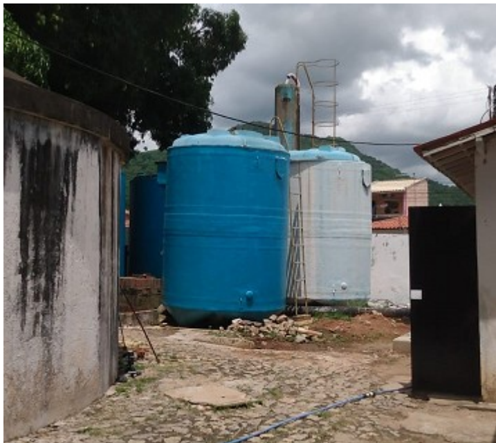
Figura 22 – Filtros da ETA Guaiuba.
