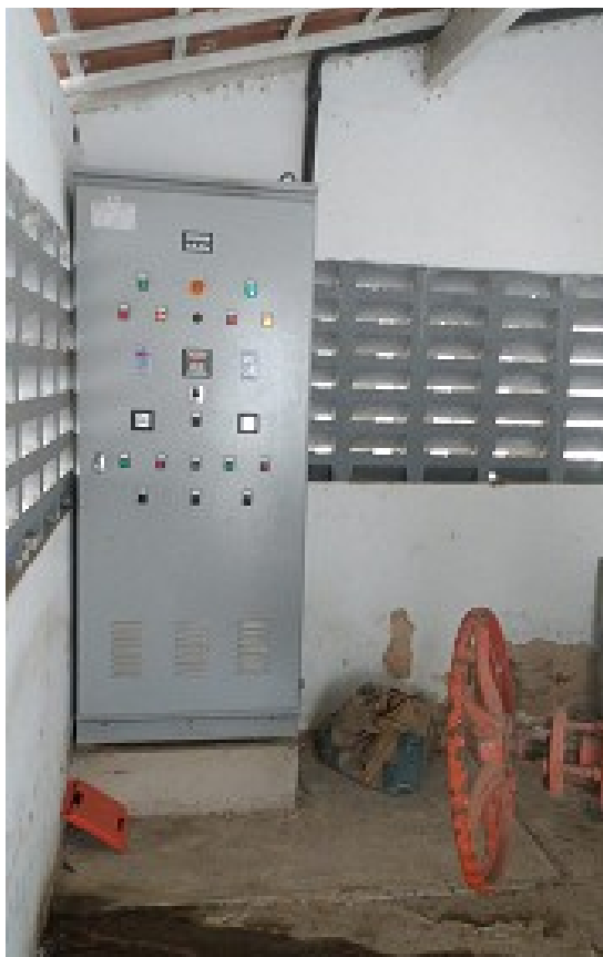
Figura 30 – EEAT-01: Quadro de comando das bombas.
