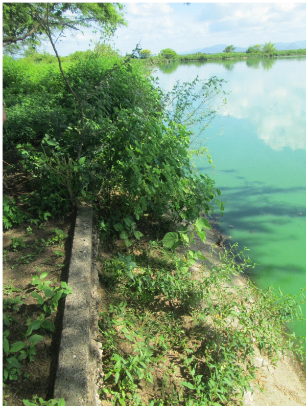
Figura 48 – Presença de vegetação alta no talude da Lagoa Facultativa da ETE Guaiúba.
