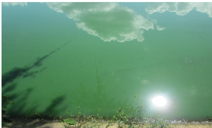
Figura 47 – Presença de material sobrenadante na Lagoa Facultativa da ETE Guaiúba.
