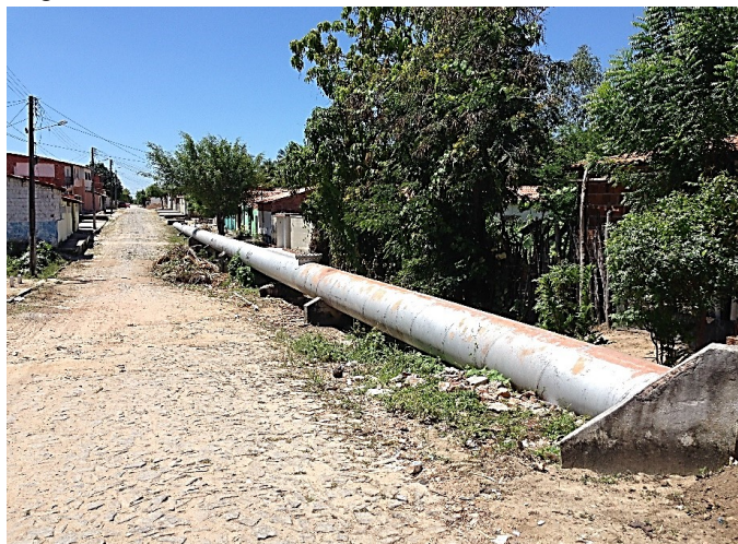
Figura 18 – Adutora de Água Bruta, DN 800.
