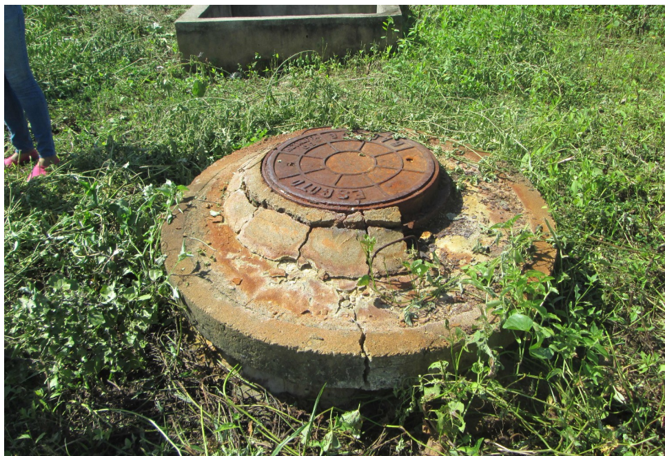
Figura 43 – Poço de Visita na ETE Guaiúba.
