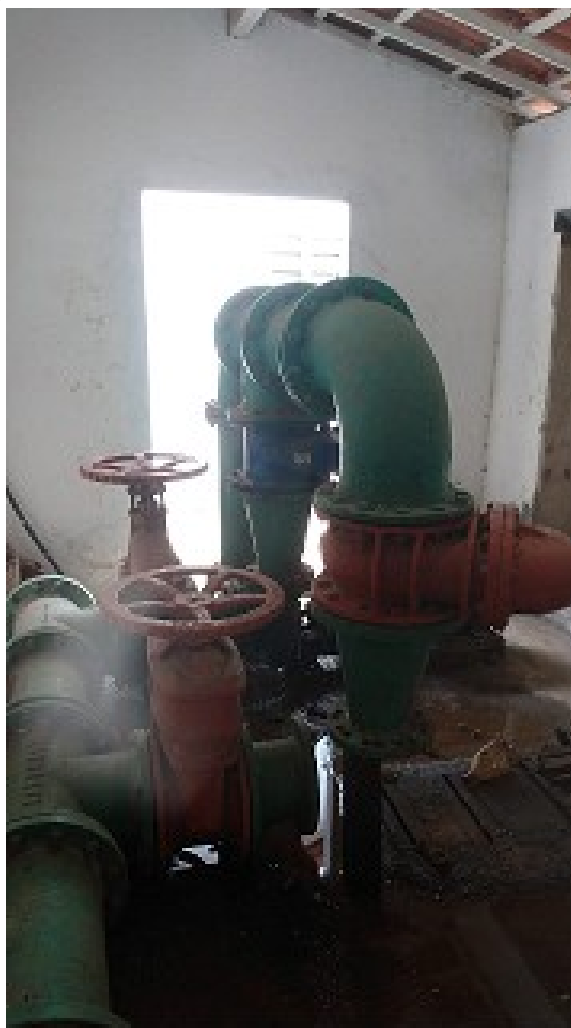
Figura 29 – EEAT-01: Conjuntos Motor-Bomba.
