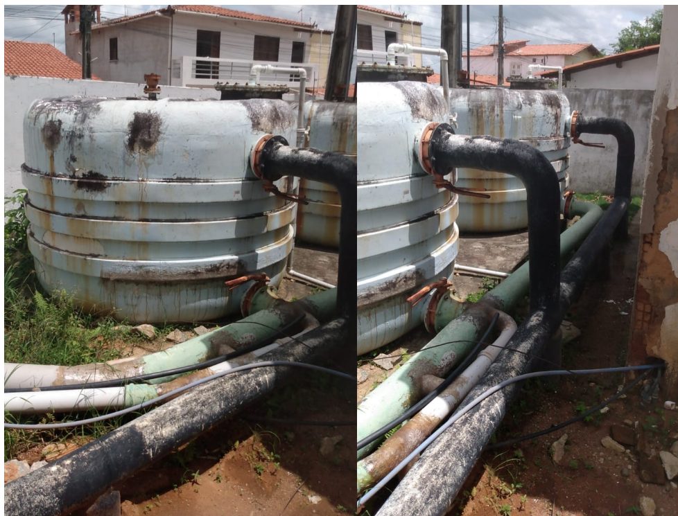
Figura 21 – Filtros de Pressão.
