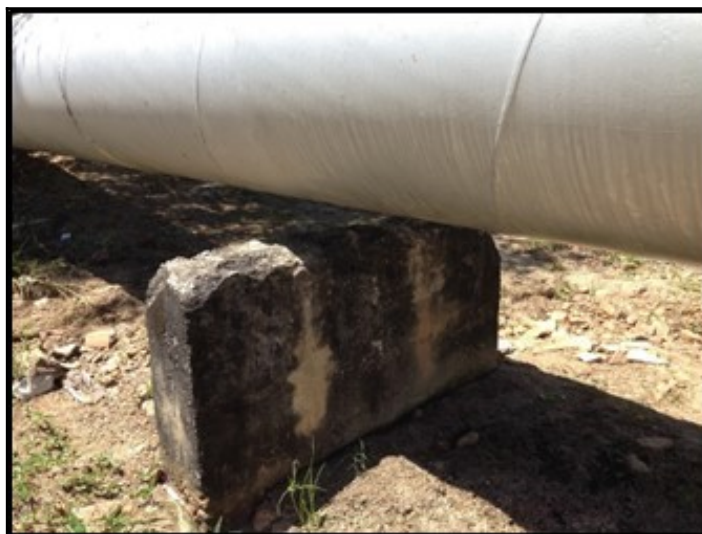
Figura 19 – Detalhes da Adutora de água bruta – AAB, notar a base de suporte da tubulação quebrada.
