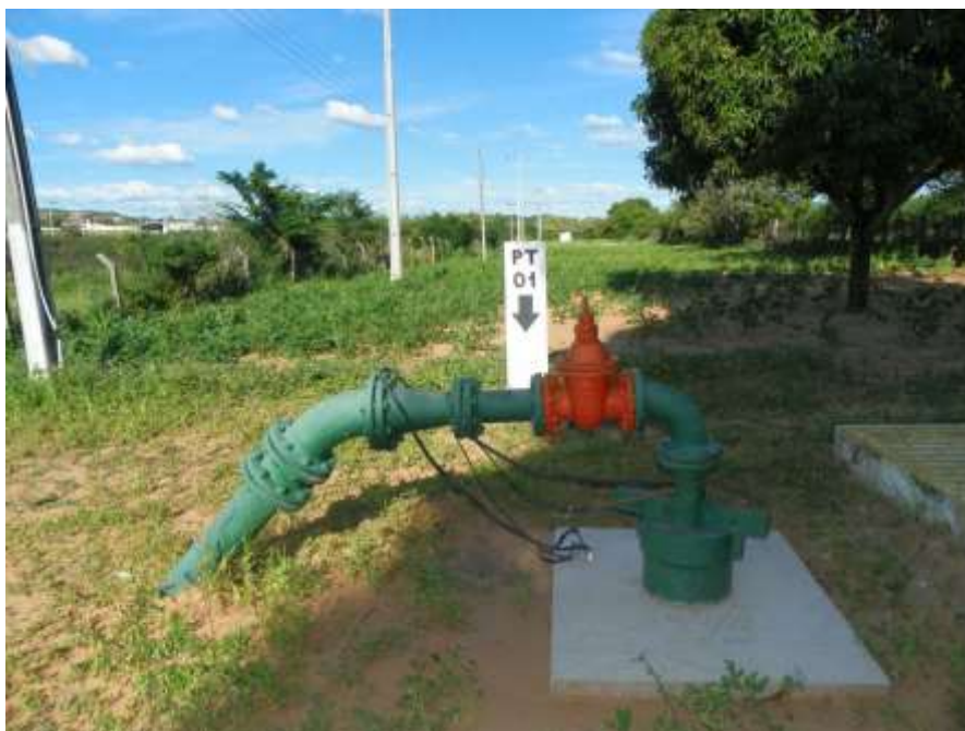
Figura 5.1 – Vista do poço tubular PT-01 (Q = 44,6 m 3 /h) localizado dentro da ETA que faz parte do manancial da sede de Missão Velha.
