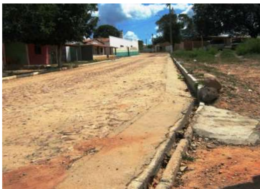
Figura 5.24 – Vista de sarjeta precária na Rua Principal do distrito de Quimami (ponto de alagamento). Fonte: Consórcio DGH-Cariri (2012).
