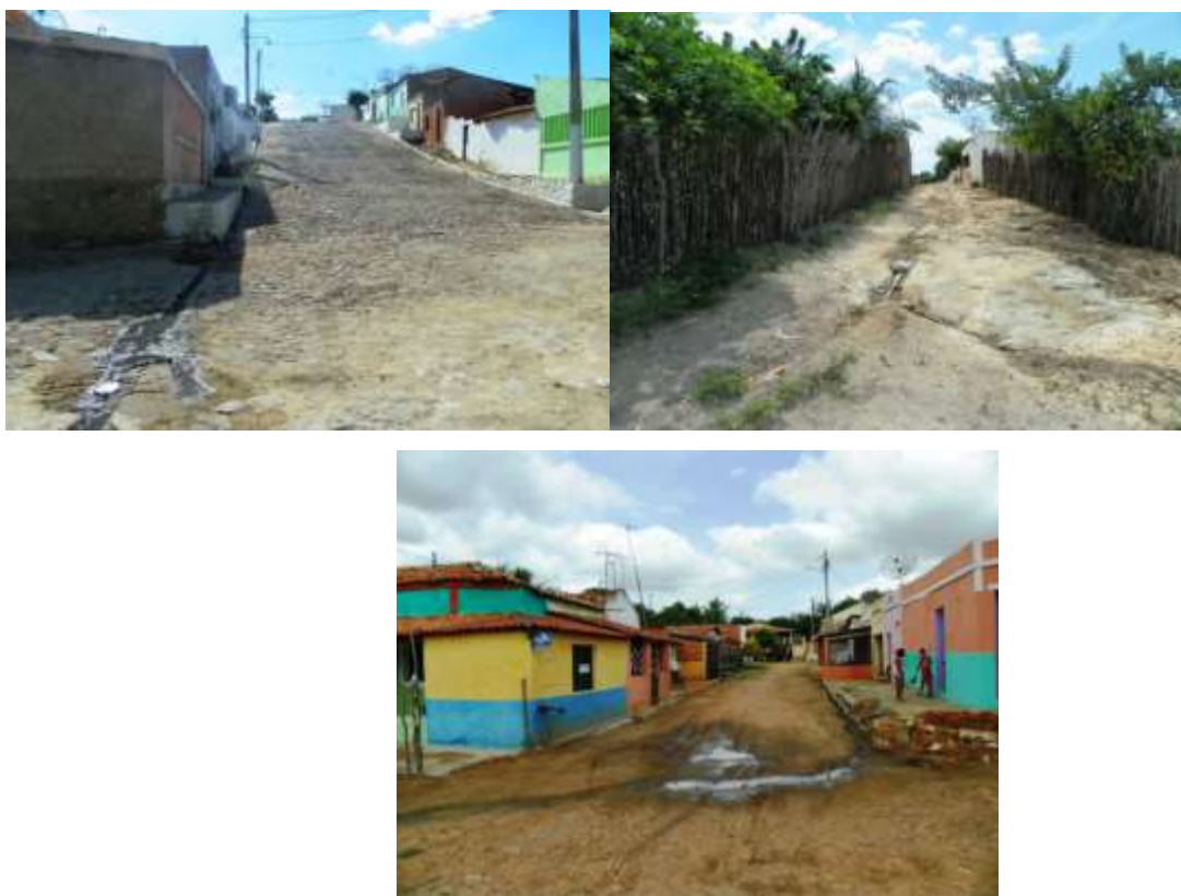
Figura 5.19 – Esgoto a céu aberto nos distritos de Jamacaru, Quimami e Missão Nova
