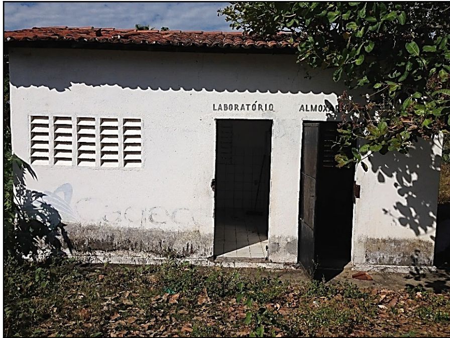
Figura 40 – Laboratório e almoxarifado – ETE Pacatuba.
