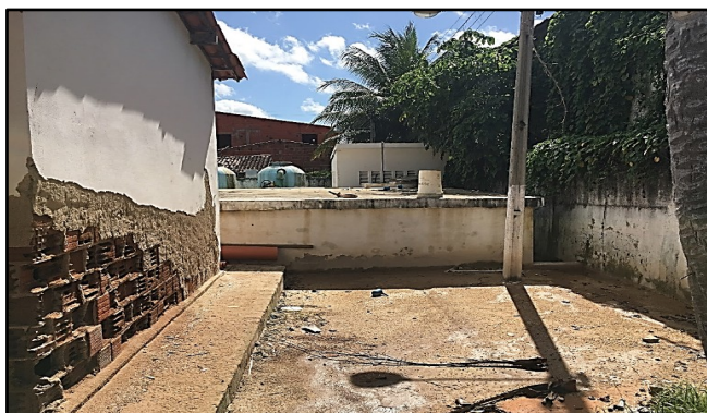
Figura 19 – Reservatório Semienterrado (RSEN-01) desativado – Pacatuba.
