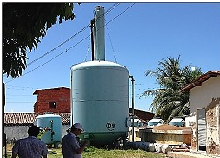
Figura 17 – Câmara de Carga – ETA Pacatuba.
