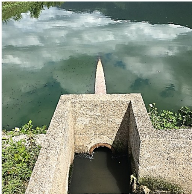
Figura 38 – Lagoa Facultativa – ETE Pacatuba.
