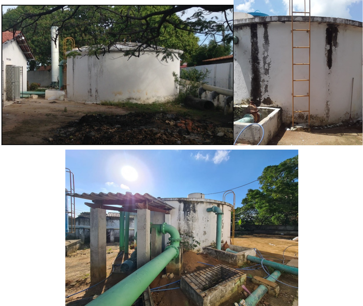
Figura 25 – Estrutura do RAP-01 na ETA-Pavuna.
