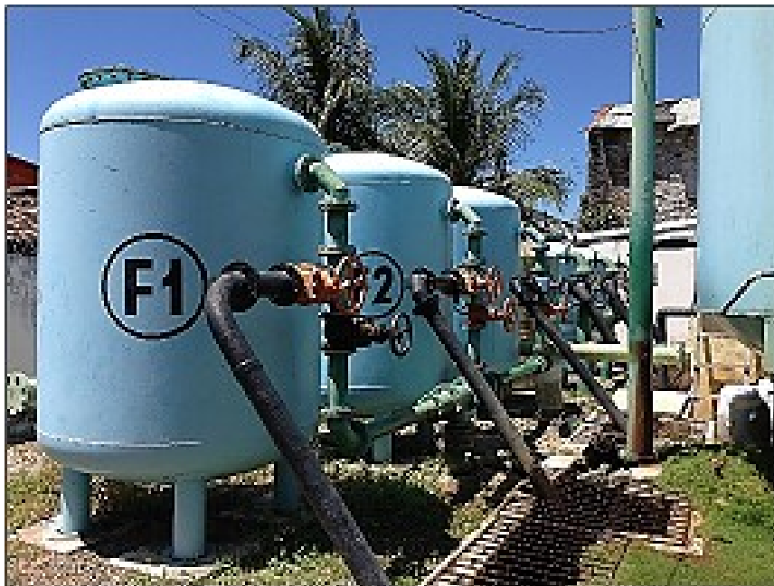
Figura 18 – Filtros de Fluxo Ascendente – ETA Pacatuba.
