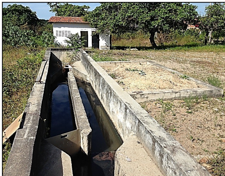
Figura 37 – Caixa de areia com Calha Parshall – ETE Pacatuba.
