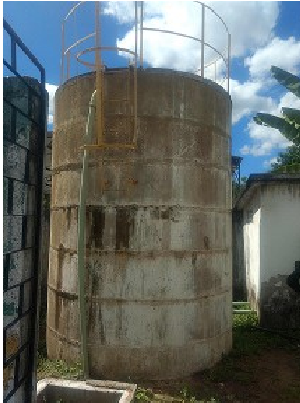
Figura 21 – Reservatório Apoiado 01 com escada de acesso danificada.
