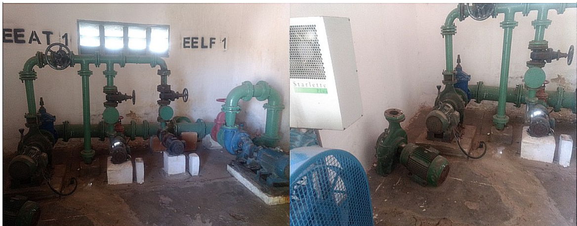
Figura 26 – EEAT-01 e EELF-01 – ETA Pavuna.
