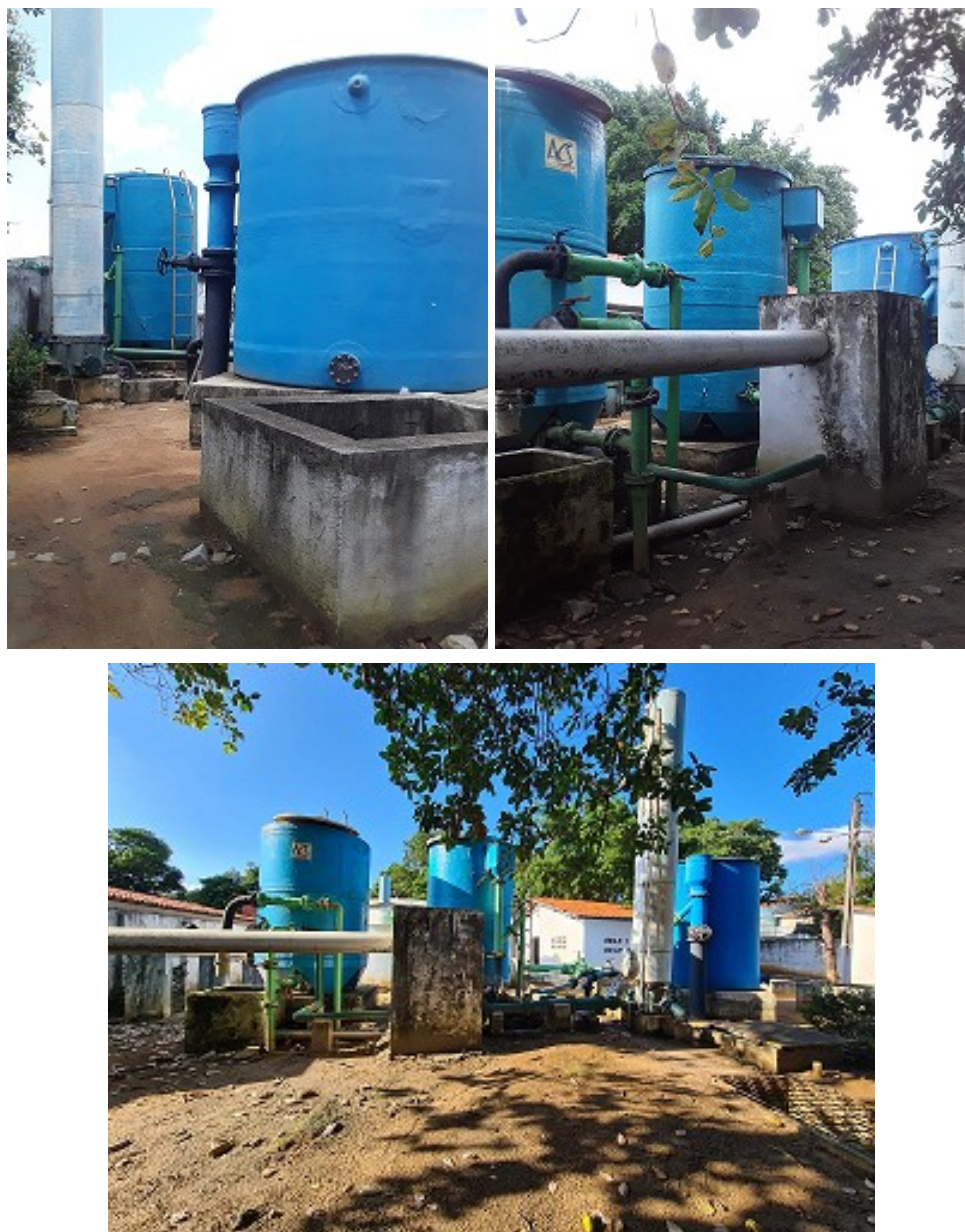
Figura 24 – Filtros de fluxo ascendente da ETA de Pavuna.
