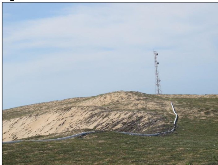
Figura 5.8 - Adutora de água bruta utilizada pela Petrobrás S.A.
