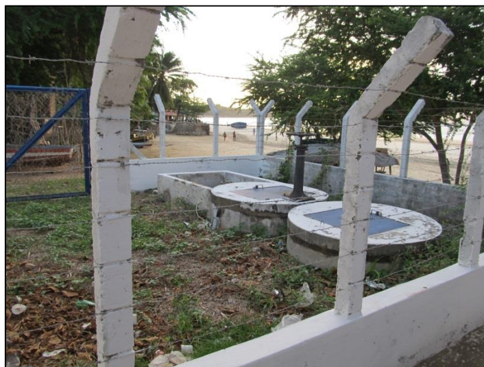
Figura 6.9 - Estação Elevatória de Esgotos (EEE3) inativa.
