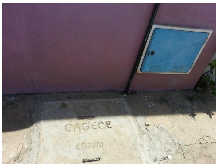
Figura 6.5 - Caixa de passagem de esgotos instalada na região central do município.
