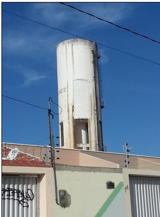
Figura 5.16 - Reservatório Vila São Bernardo (REL-01)
