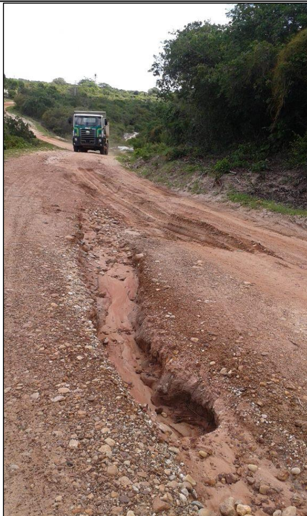
Figura 7.1 - Inexistência de sistema de drenagem (erosão) - Estrada Piriquara. Fonte: SEINFRA, 2014.
