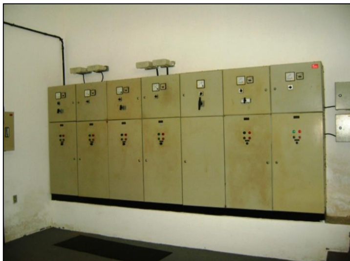
Figura 5.23 - Vista dos Quadros de comando das elevatórias EECS-01, EEAT-01 e EELF-01 Fonte: ARCE (2011)
