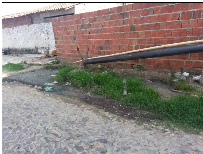
Figura 6.1 - Lançamento irregular de esgotos domésticos em vias no bairro CCF.
