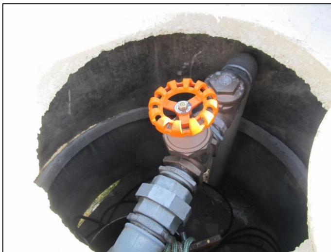
Figura 5.12 - Detalhe da tubulação do Poço Campo da Aviação.
