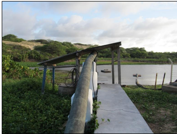
Figura 5.19 - Adutora de água bruta para a ETA
