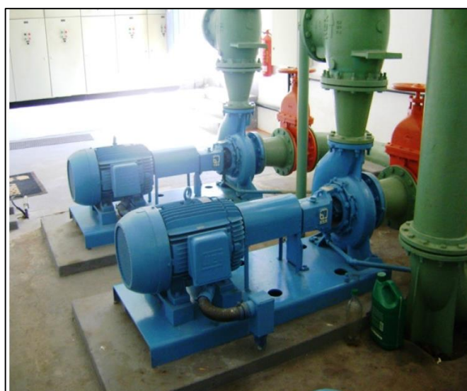
Figura 5.22 - EELF-01 – Conjuntos motores-bomba
