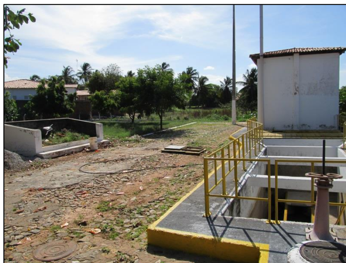
Figura 6.8 - Estação Elevatória de Esgotos (EEE2) com leito de secagem de materiais sólidos
