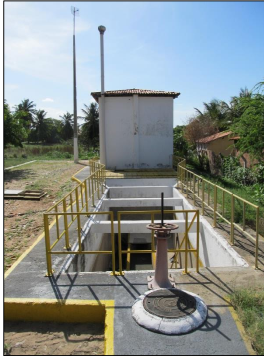
Figura 6.7 - Estação Elevatória de Esgotos (EEE2) com sistema de tratamento preliminar (gradeamento e desarenação).
