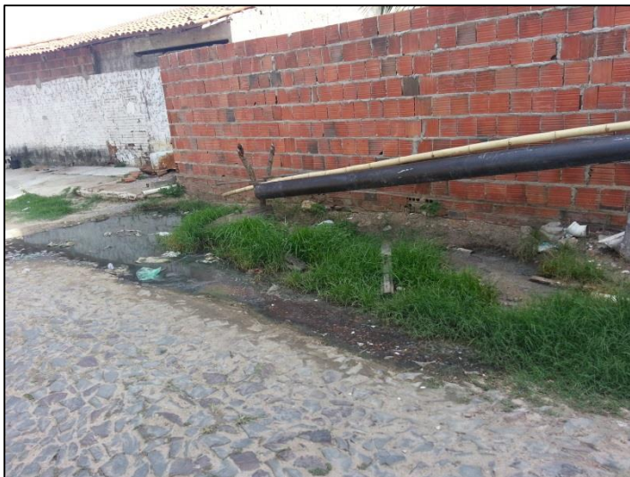
Figura 6.13 - Lançamento irregular de esgotos domésticos em vias no bairro CCF.
