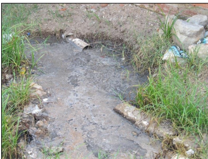
Figura 6.14 - Ponto com lançamento irregular de esgotos no bairro CCF.
