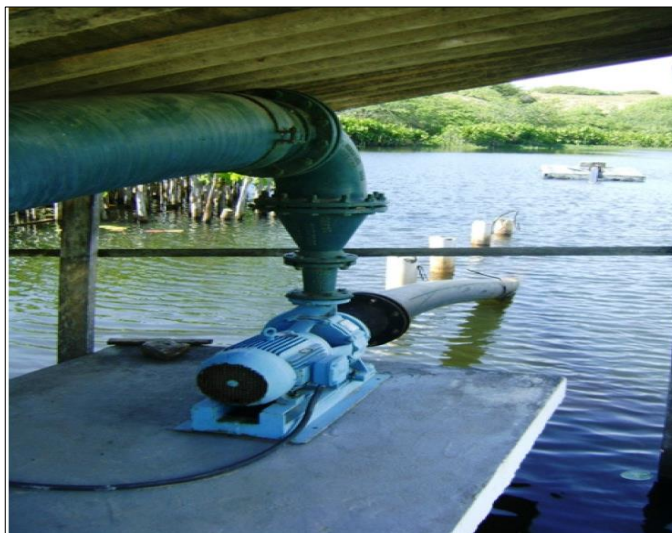
Figura 5.5 - Vista do conjunto motor-bomba Fonte: ARCE (2011)
