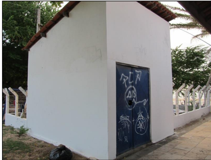
Figura 6.10 - Casa de bombas da Estação Elevatória de Esgotos (EEE3) inativa.
