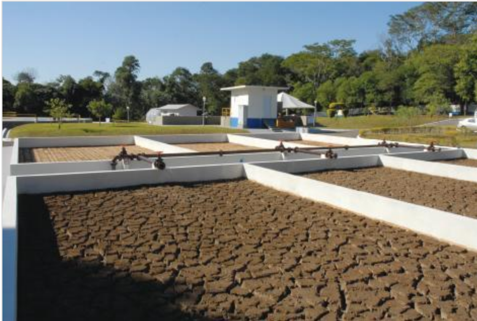
Figura 7.2 - Leito de secagem de lodo de esgoto
