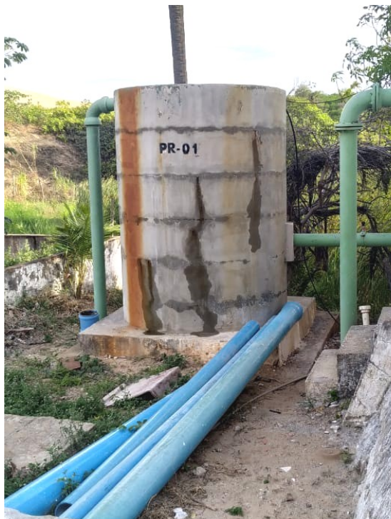
Figura 49: Poço de reunião PR-01 da ETA Siupé no município de São Gonçalo do Amarante – CE.
