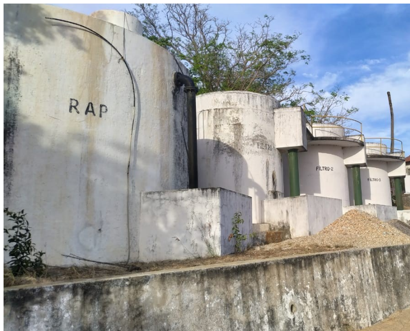
Figura 52: Reservatório apoiado RAP-01 do SAA Siupé.
