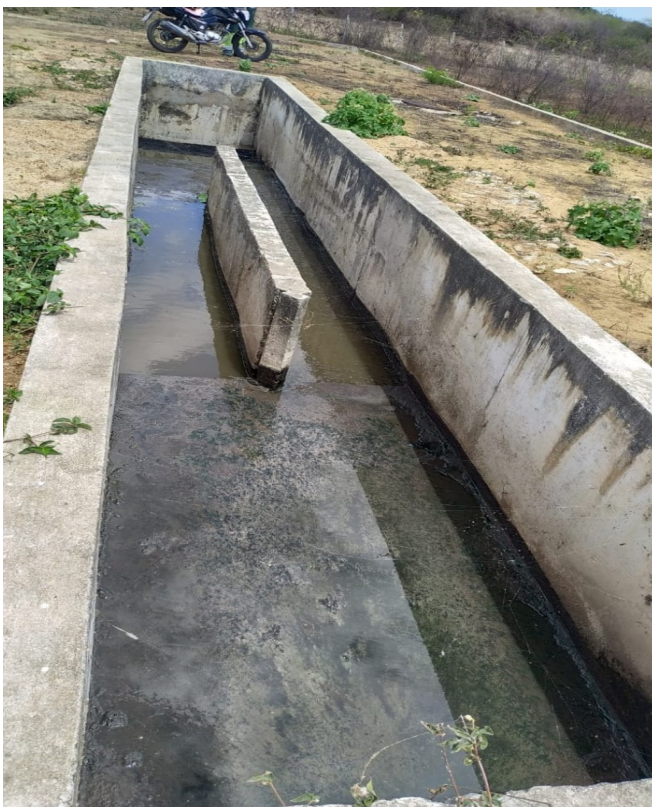
Figura 83: Unidade de tratamento preliminar (caixa de areia com Calha Parshall) da ETE Croatá do município de São Gonçalo do Amarante – CE
