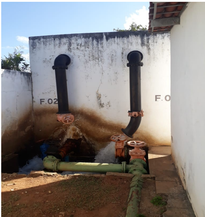
Figura 60: Unidade de filtração de fluxo ascendente.
