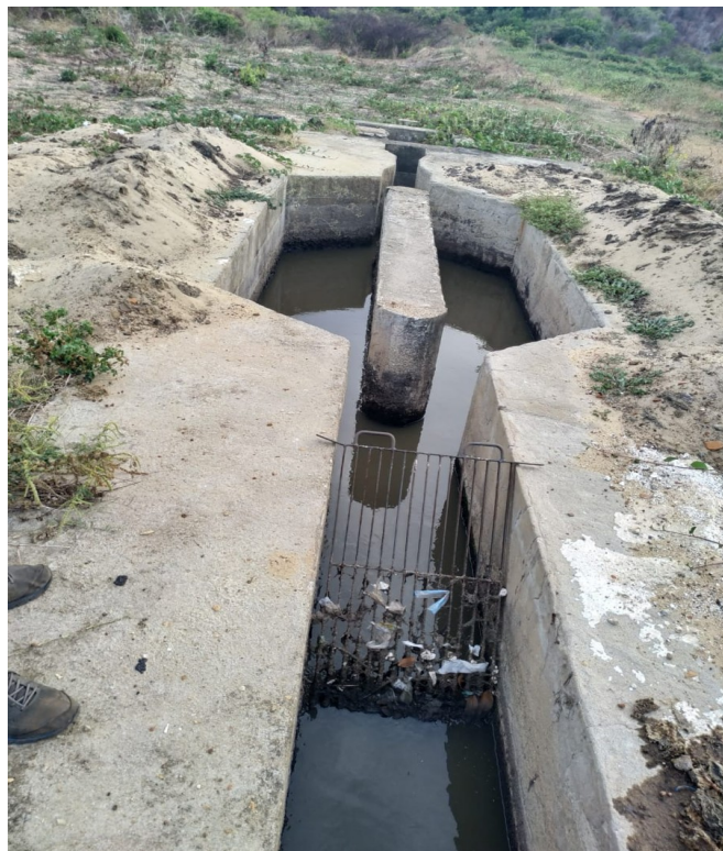
Figura 77: Unidade de tratamento preliminar (gradeamento, caixa de areia e Calha Parshall) do SES Pecém do município de São Gonçalo do Amarante – CE
