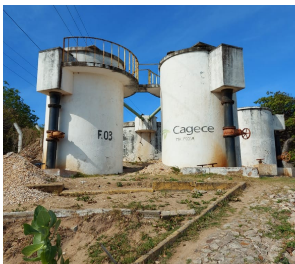
Figura 39: Unidade de filtração de fluxo ascendente.
