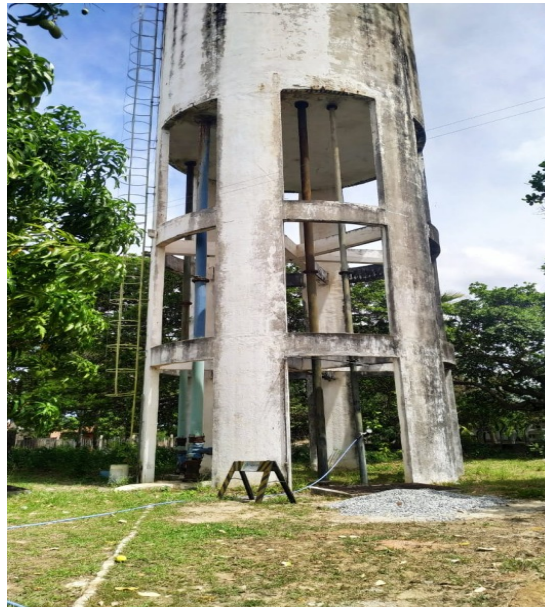
Figura 26: Reservatório elevado REL-03.
