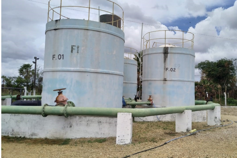
Figura 22: Unidade de filtração de fluxo ascendente.
