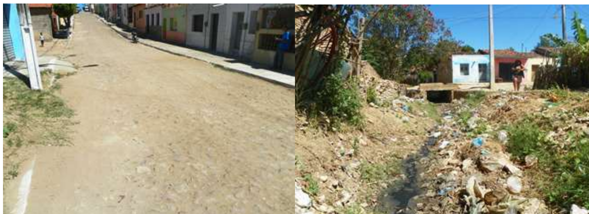
Figura 5.14 – Pontos de alagamento/inundação nas Ruas 11 de Janeiro (esquerda) e São Pedro (direita).
