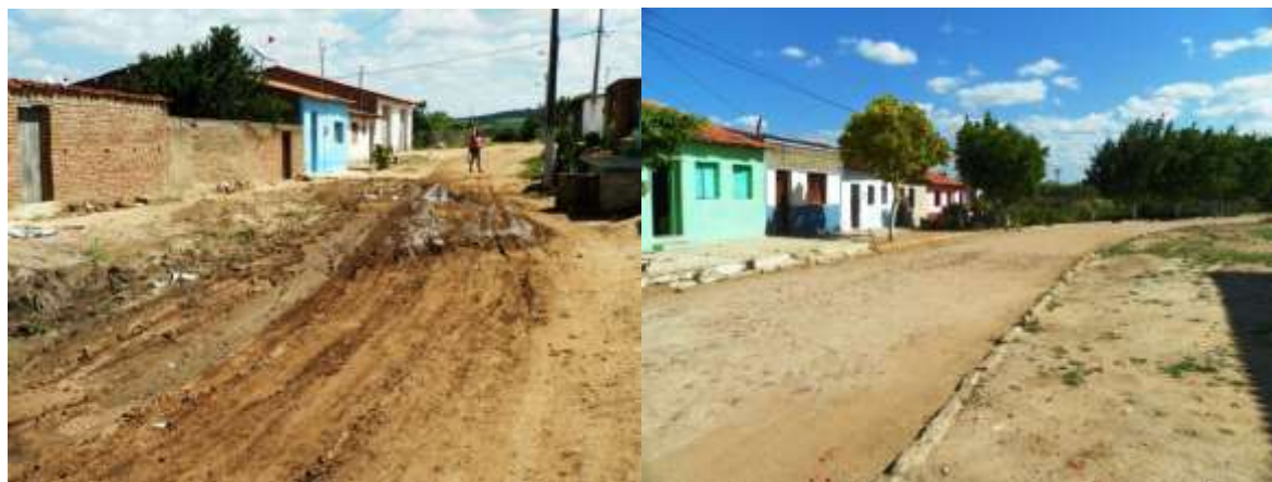
Figura 5.15 – Pontos de alagamento/inundação na Rua Nossa Senhora da Saúde (esquerda) e Rua do Comércio (direita).
