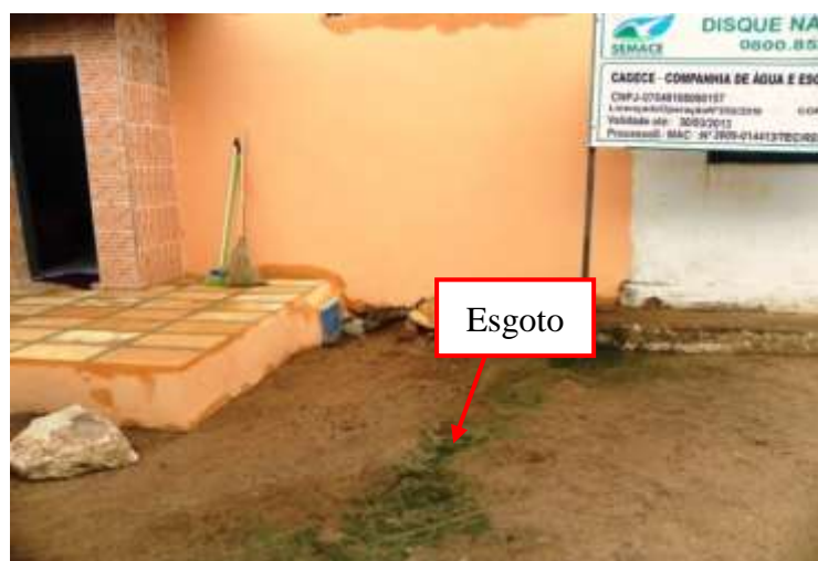
Figura 5.6 – Lançamento de esgoto a céu aberto na Rua Central. Fonte: Consórcio DGH-Cariri (2011).
