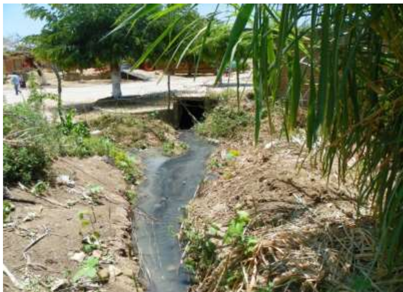
Figura 5.3 – Despejo de esgoto a céu aberto ao final da rede Fonte: Consórcio DGH-Cariri (2011).
