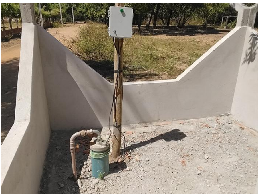
Figura 5.28 – Captação subterrânea do SISAR na localidade de Saraiva em Viçosa do Ceará
