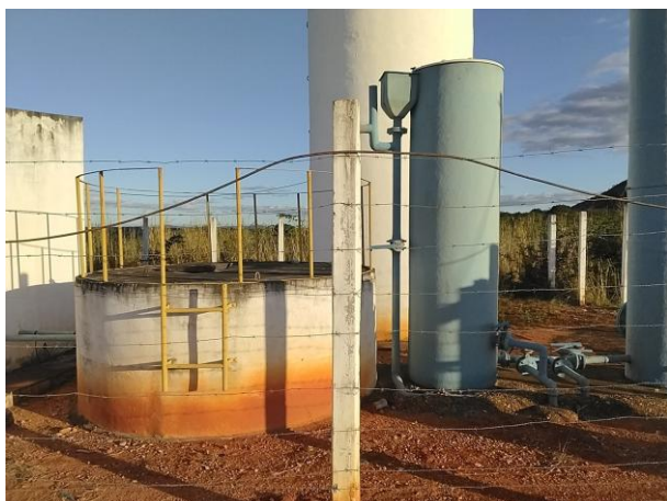
ETA Cajueiro, operada pelo SISAR em Farias Brito (Filtração e Desinfecção)
