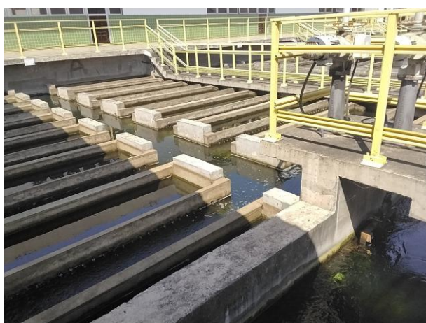
ETA Oeste, operada pela CAGECE em Caucaia (Tratamento Convencional)
