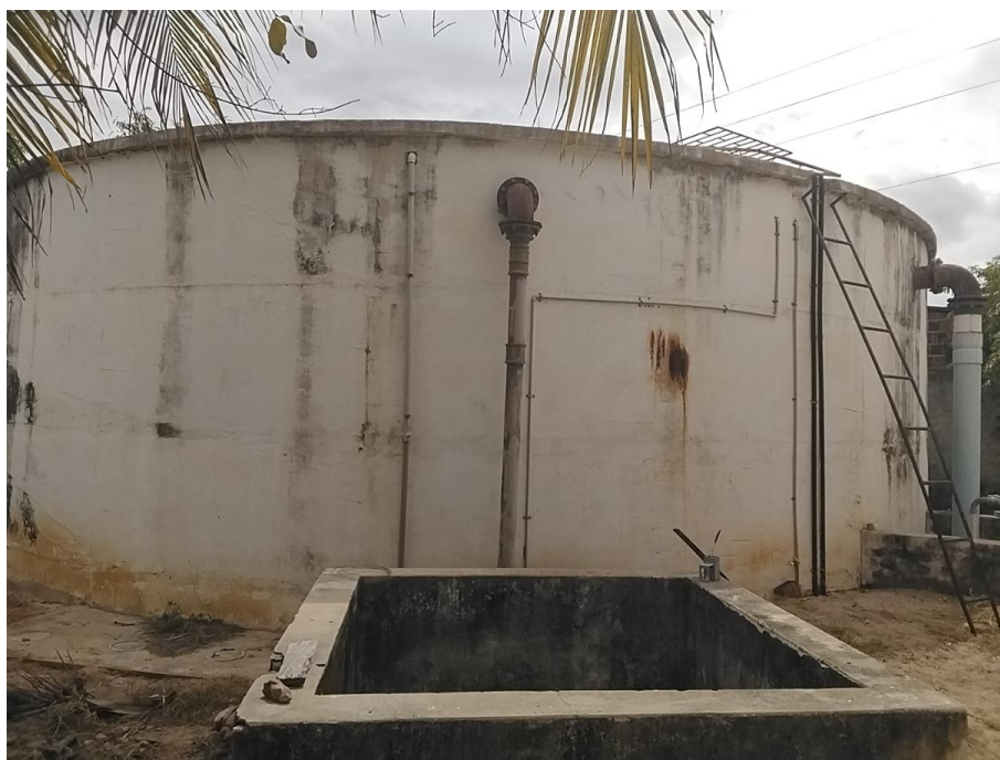
Figura 4.12 – Reservatório apoiado em área rural operada pelo SAAE Limoeiro do Norte
