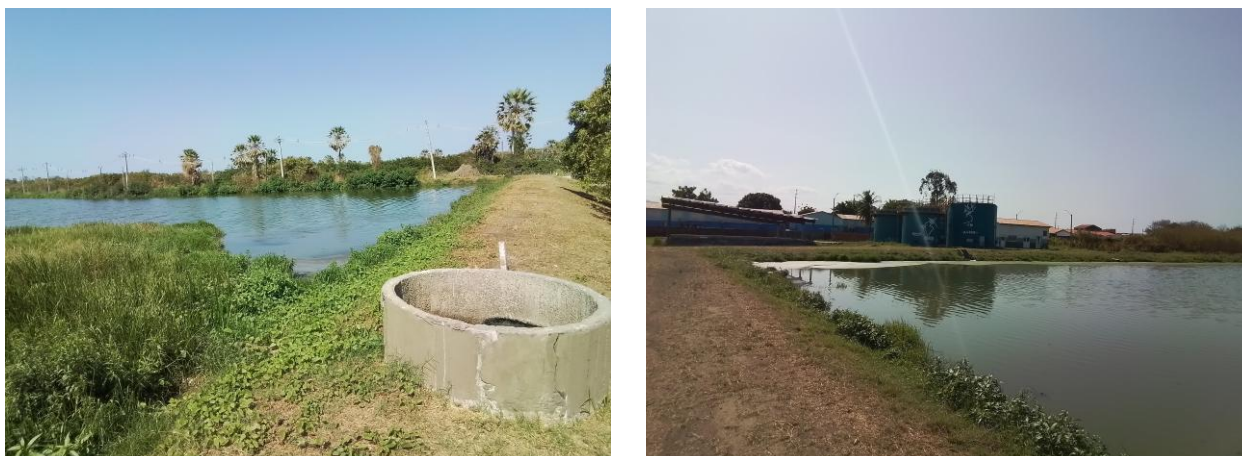
Figura 6.22 – Exemplo de ETE com lagoas de estabilização no Ceará - ETE CJ Jereissati III (Maracanaú)
