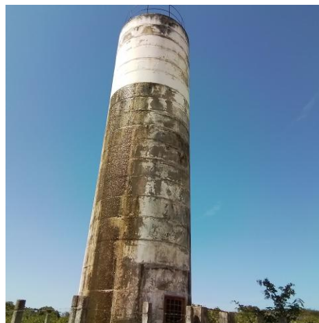
Reservatório elevado do SAAE Camocim
