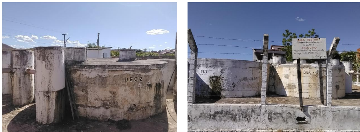
Figura 6.21 – Exemplo de ETE com decanto-digestores no Ceará - ETE Saboeiro (Saboeiro)
