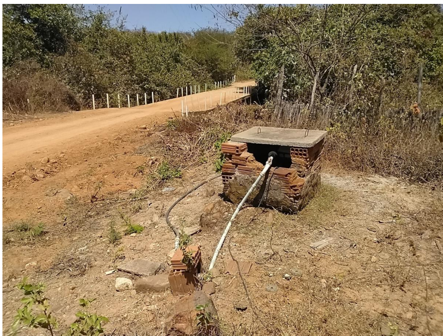
Figura 4.21 – Captação subterrânea em SAA operado por associação comunitária rural não filiadas ao SISAR em Ipaporanga
