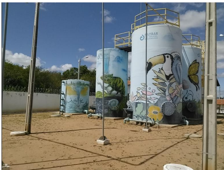
Figura 4.10 – Vista dos reatores UASB da ETE São Bento II
