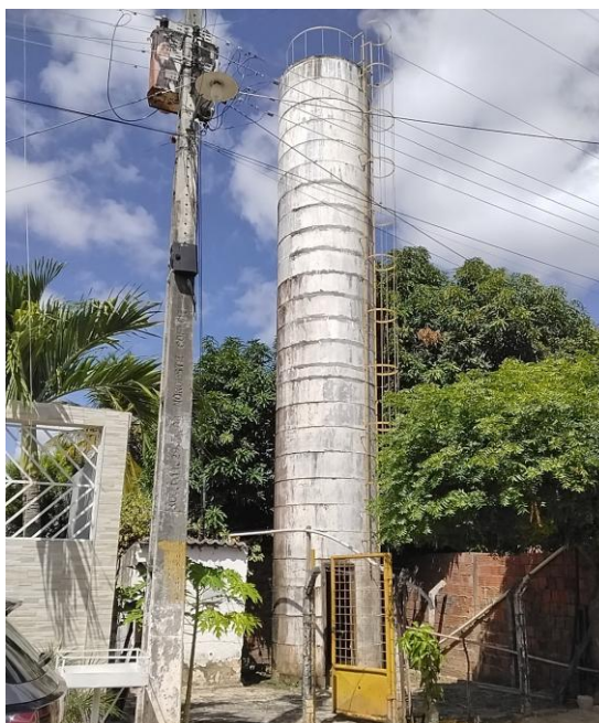
Figura 5.37– Reservatório elevado na localidade de Vila Mingu em Milagres cuja água é distribuída bruta
