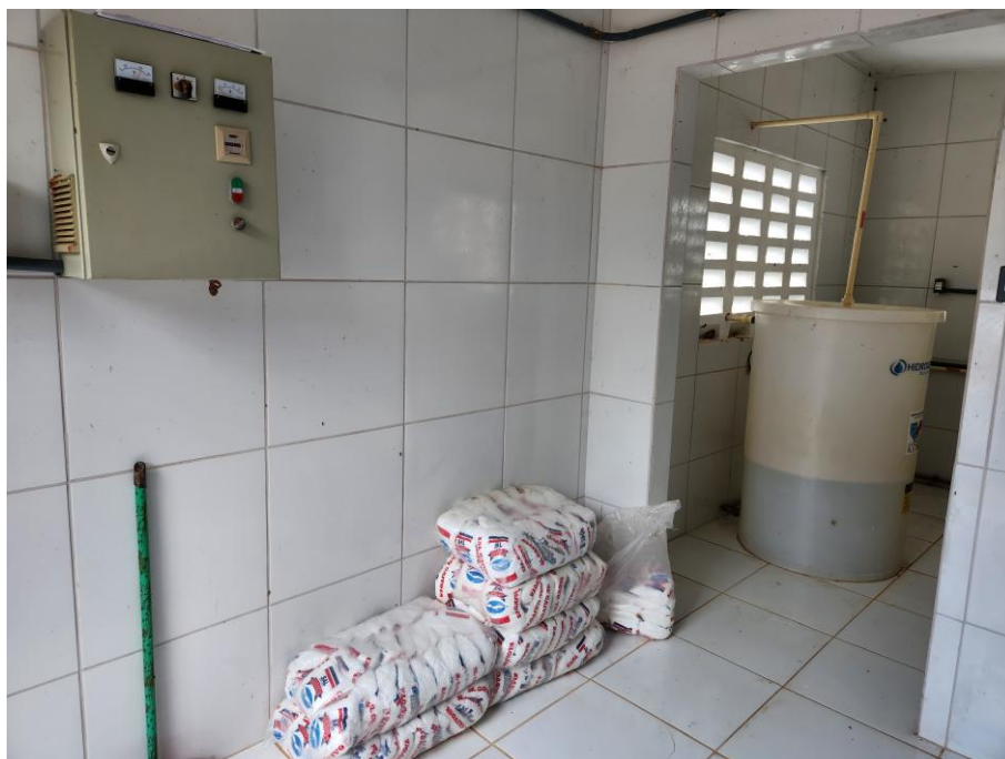
Figura 5.44 – Fabricação de cloro na unidade de desinfecção do SISAR Passagem de Pedras em Brejo Santo
