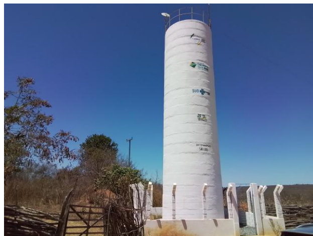
Reservatório elevado do SISAR em Quiterianópolis
