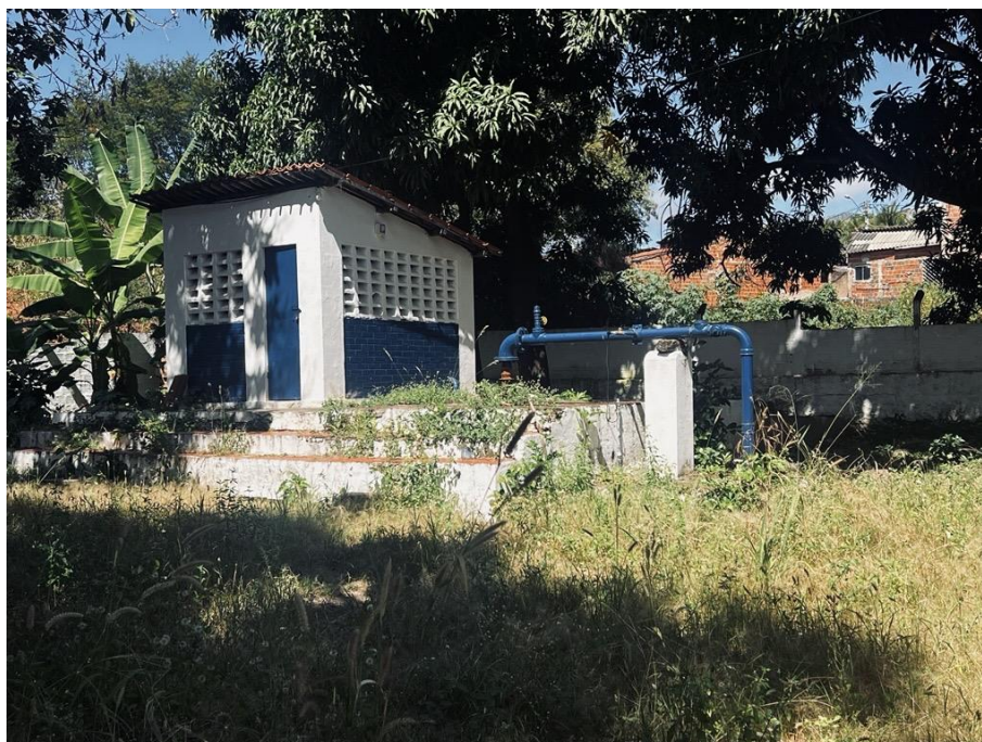
Figura 4.16 – Captação subterrânea do sistema da sede municipal operada pelo SAAEC
